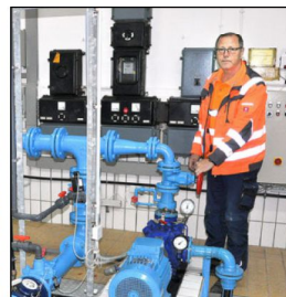
Wassermeister Klaus Dinkel steuert im Pumpwerk die Wasserversorgung im Ort. Zu 85 Prozent kommt das Wasser aus der Hetzenlochquelle. Foto: Roland Wolf
